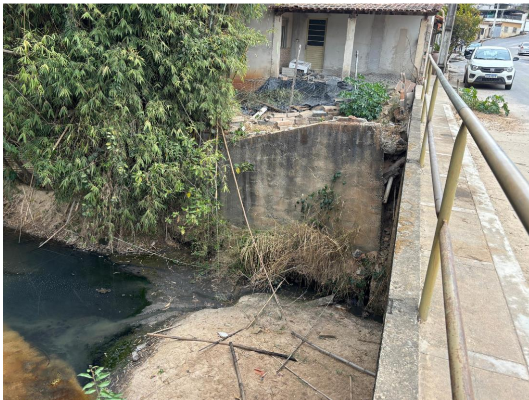
Figura 3 – Ala direita à jusante danificada durante as chuvas intensas.
