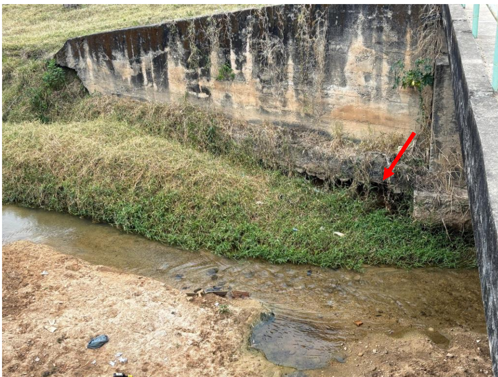
Figura 1 – Seta indicando a área onde será necessário realizar concretagem para proteção das estacas.
