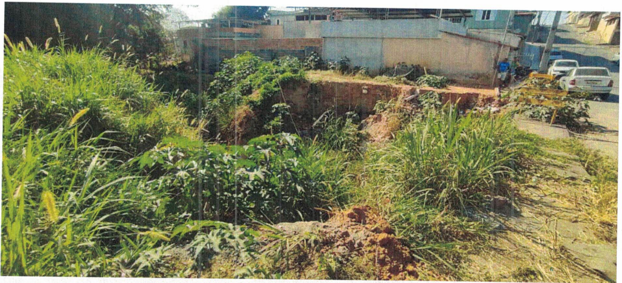
Foto 4 – Processo erosivo às margens do córrego Bela Vista.
