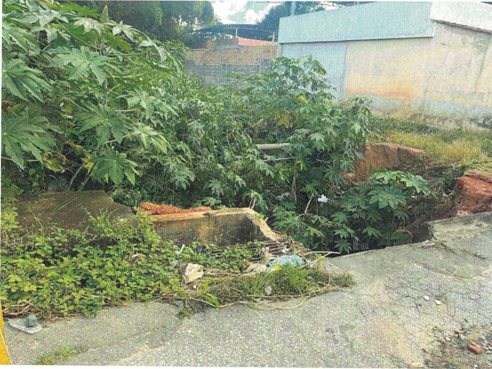
Foto 5 – Vista atual do processo erosivo.
