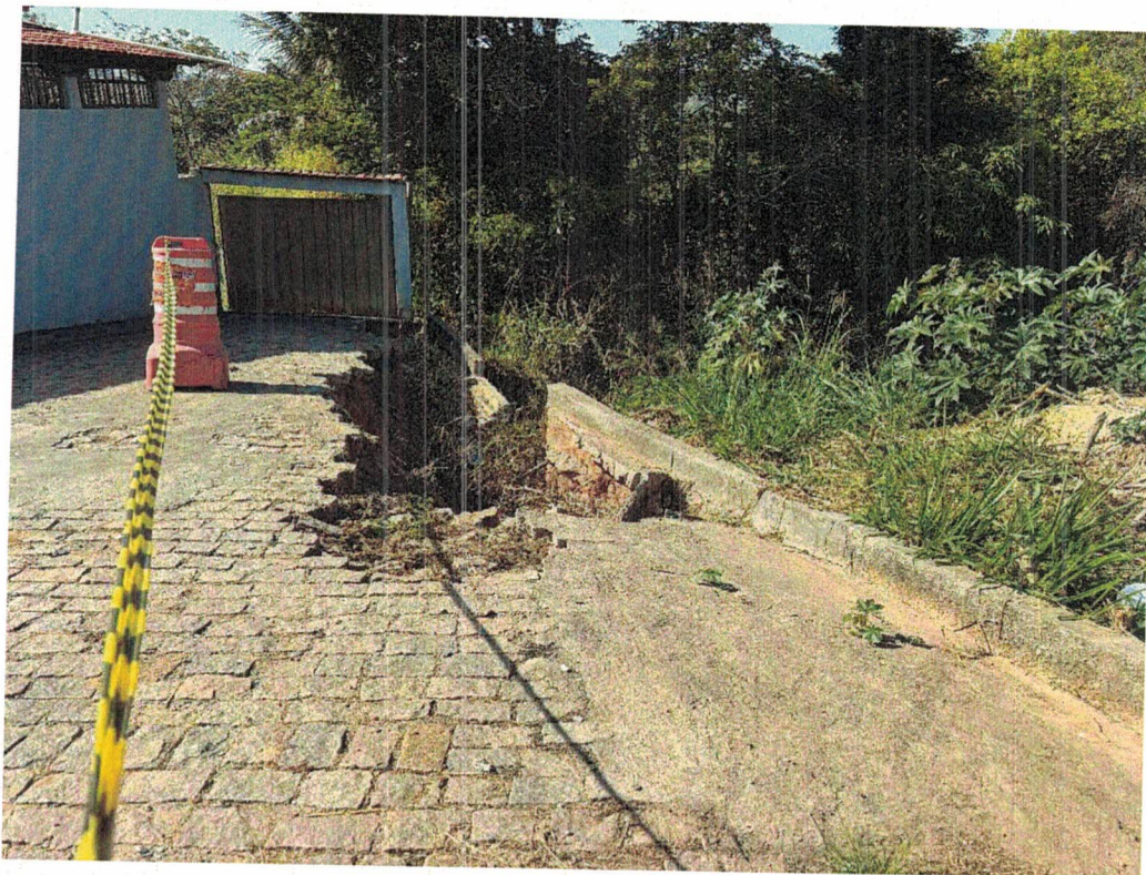
Figura 7 – Trecho da rua danificado
