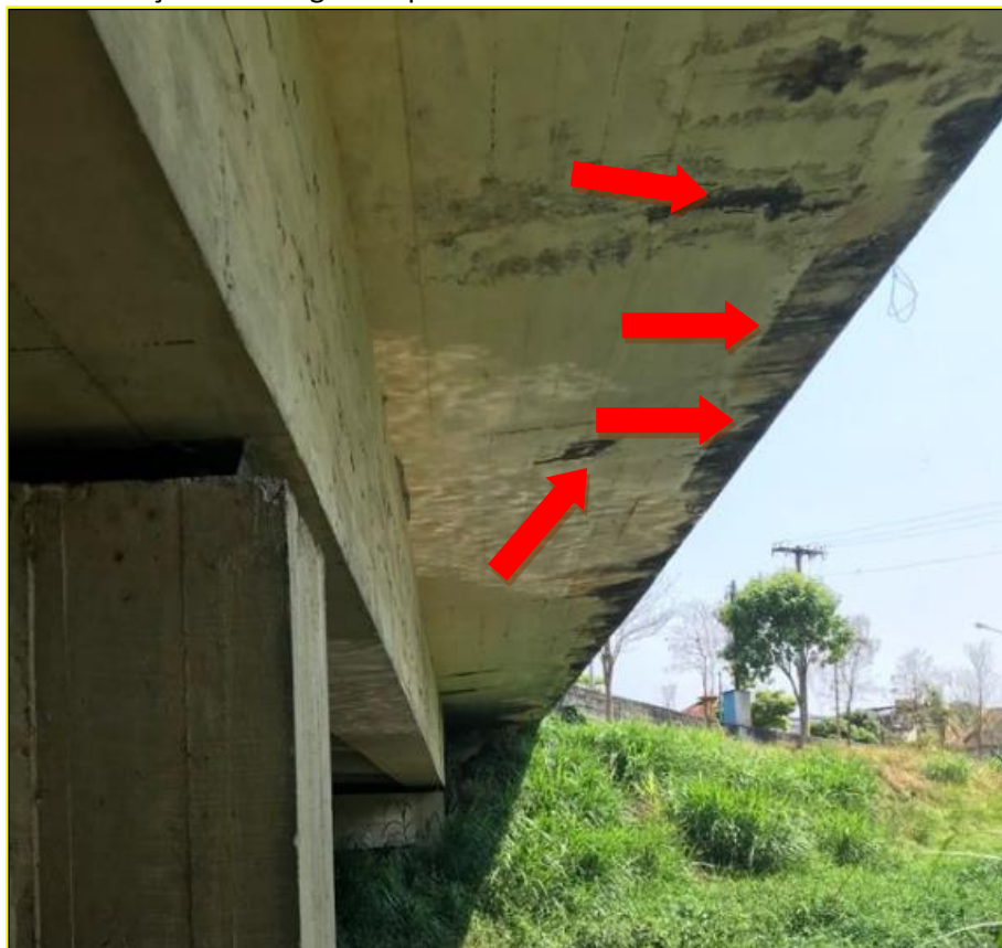
Figura 19 – Ausência de pingadeiras, ocasionando deterioração da estrutura de concreto e posteriormente a oxidação de ferragens expostas.
