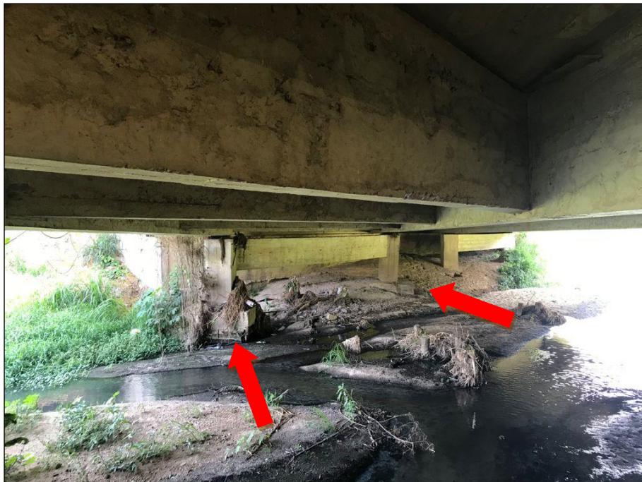
Figura 11. Bloco a proteger – ferragem exposta
