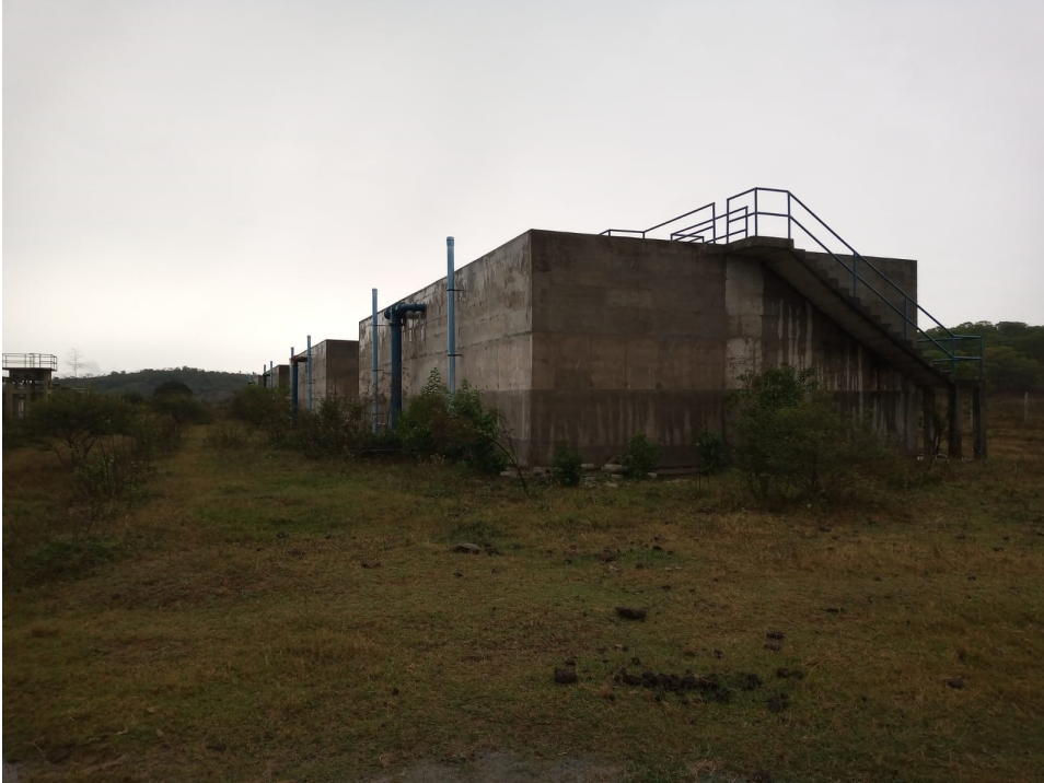
Foto 1 – Vista dos Reatores.
