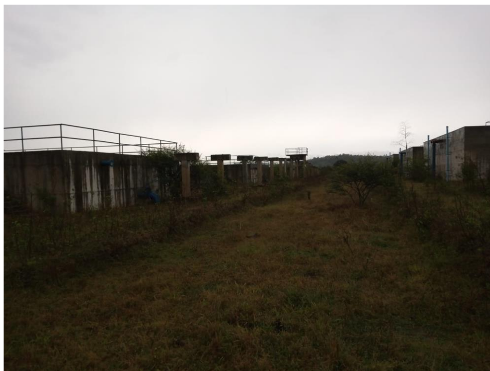
Foto 2 – Vista dos Aeradores e CDV 2
