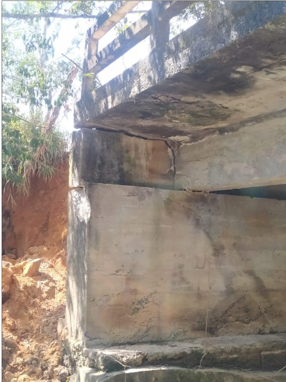
Figura 8. Rachadura observada em elemento da estrutura da ponte, podendo evoluir para o desprendimento do mesmo.
