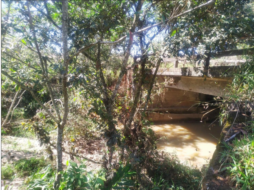
Figura 3. Vista da ponte, localizada na Comunidade Rural do Morro Cavado, danificada pela ação das fortes chuvas que ocorreram no município de Formiga/MG.
