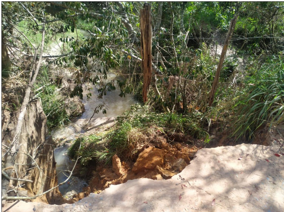
Figura 4. Movimentação de terra que ocorreu na estrada de acesso à ponte devido ao desmoronamento do encabeçamento da ponte.
