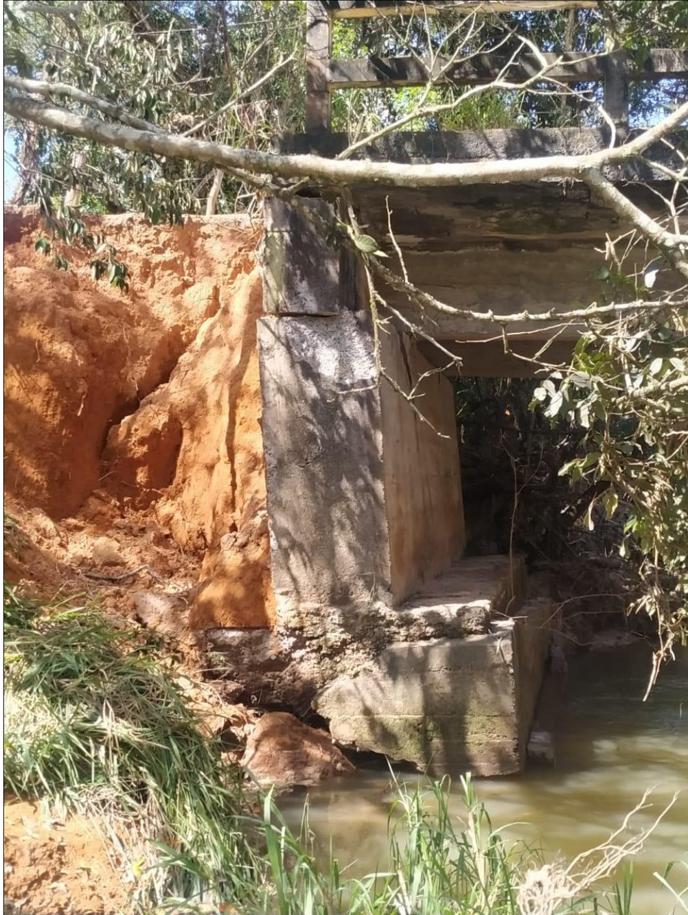
Figura 6. Apoio da ponte apresentando partes quebradas, rachaduras e inclinação em relação ao eixo central da estrutura.
