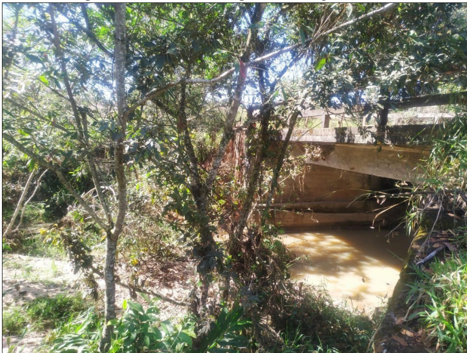
Figura 3. Vista da ponte, localizada na Comunidade Rural do Morro Cavado, danificada pela ação das fortes chuvas que ocorreram no município de Formiga/MG.
