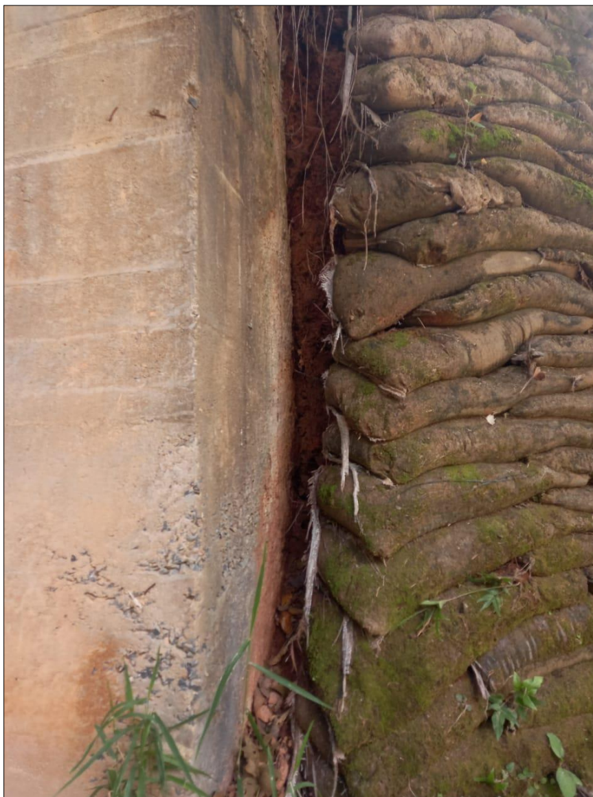
Figura 5. Figura evidenciando a contenção lateral da ponte, onde observa-se o deslocamento da mesma.
