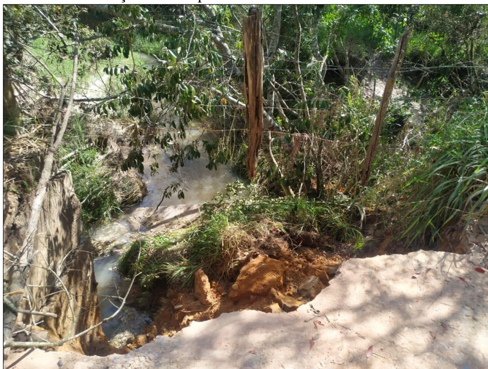
Figura 4. Movimentação de terra que ocorreu na estrada de acesso à ponte devido ao desmoronamento do encabeçamento da ponte.
