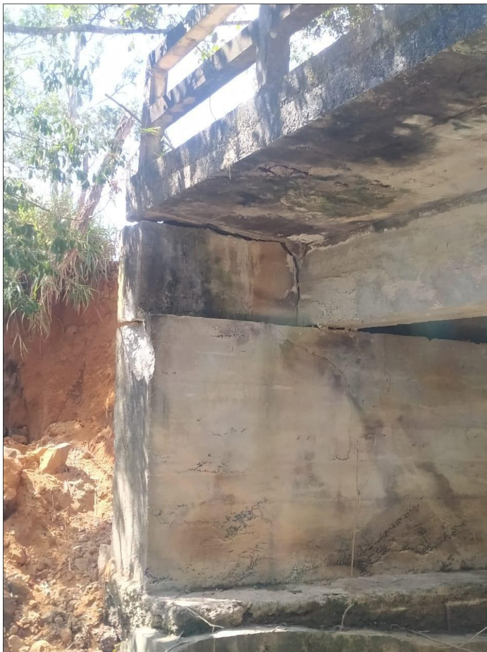
Figura 8. Rachadura observada em elemento da estrutura da ponte, podendo evoluir para o desprendimento do mesmo.
