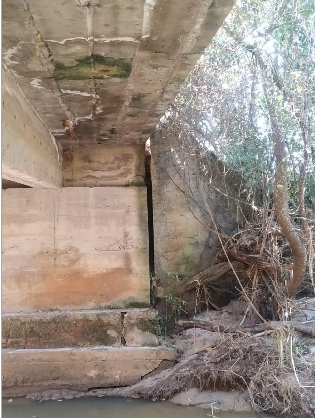
Figura 7. Na parte inferior da imagem, observa-se o apoio danificado na ponte.
