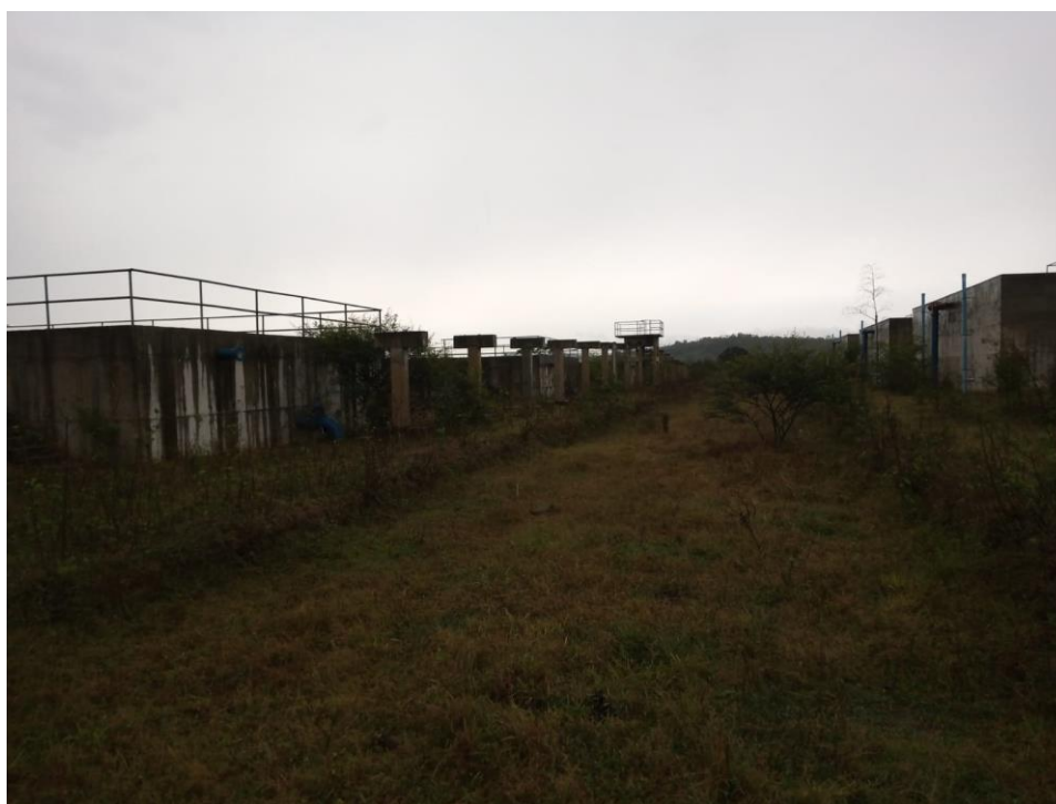
Foto 2 – Vista dos Aeradores e CDV 2
